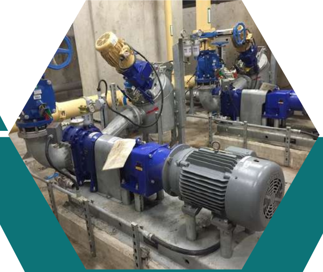
Geri Devir Pompa İstasyonu
